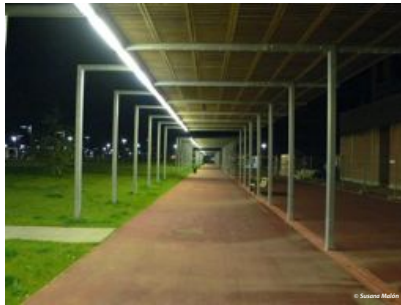
Figura 7. Sobreiluminación en zona peatonal. Nivel de iluminación existente, E_m = 169 \text{ lux} . La normativa permite un máximo de E_m = 15 \text{ lux} . Fuente: Lumínica Ambiental .
